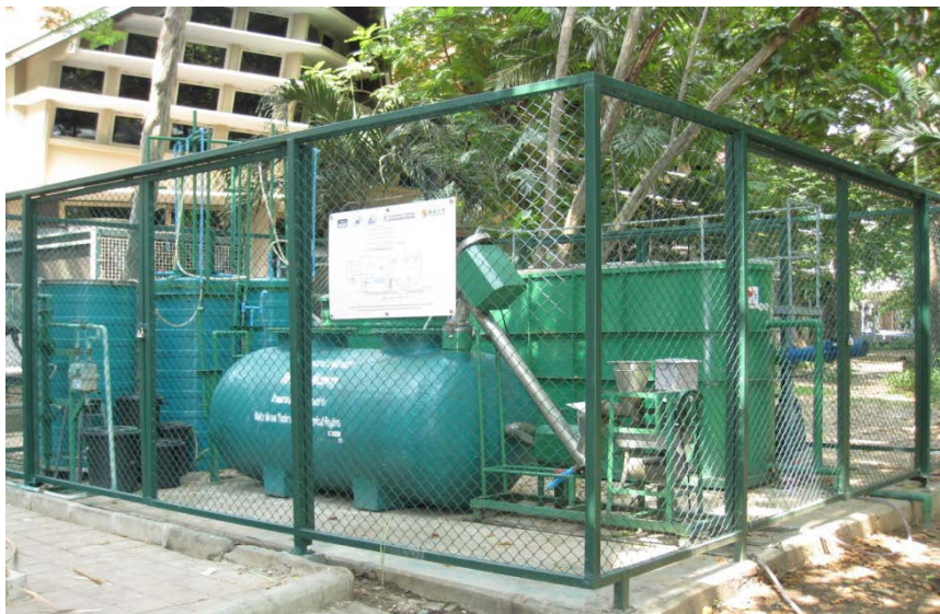
ก) ระบบชีโรเวสต์สำหรับจัดการขยะอินทรีย์และน้ำเสียอาคาร
